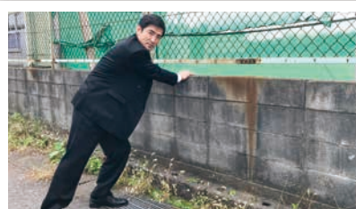
倒壊の危険性のあるブロック塀の早期回収を要望しました。
