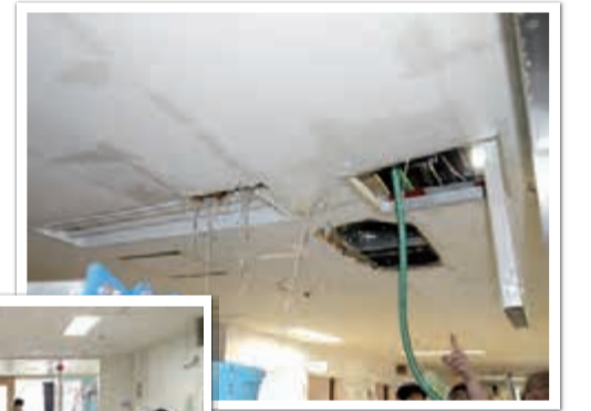
天井からの水漏れの様子
